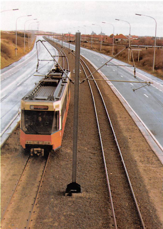
Double voie équipée de poteaux axiaux avec potences à bras obliques à Bredene (Littoral).
